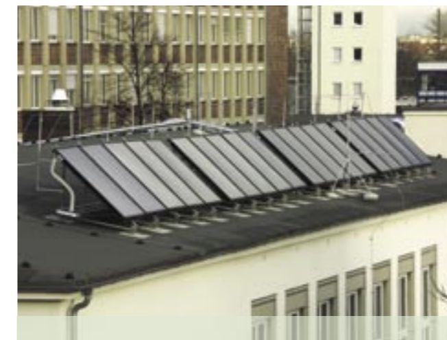
Die Solarwarmwasseraufbereitungsanlage auf der Kantine des UFZ.
