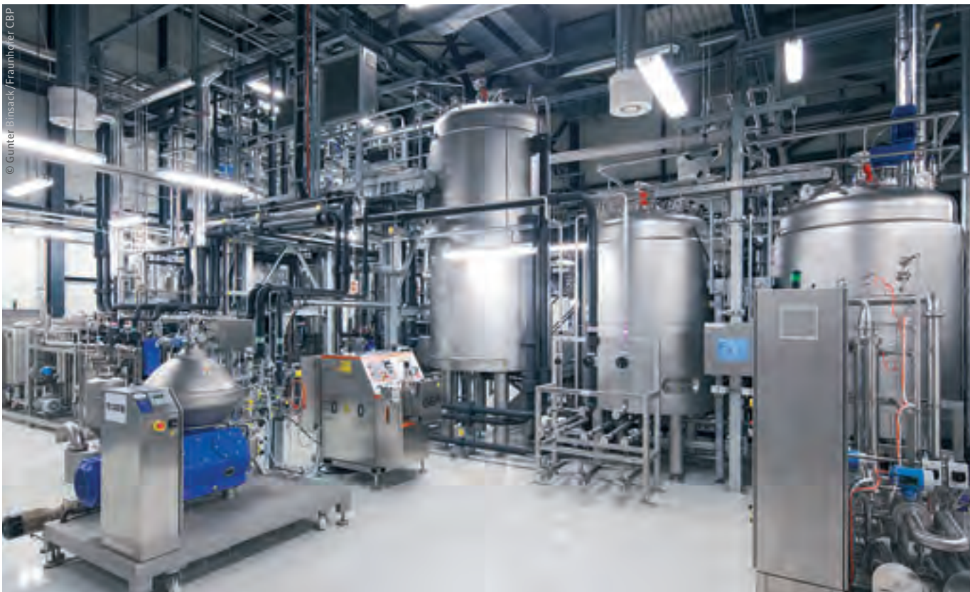
Am Fraunhofer-Zentrum für Chemisch-Biotechnologische Prozesse CBP in Leuna wird Holz in seine chemischen Einzelteile zerlegt.
